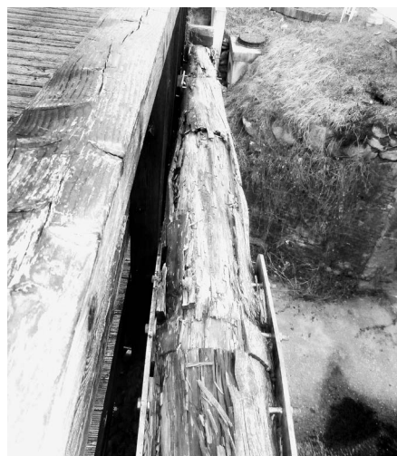
Figura 1.3. La cattiva progettazione che ha favorito il ristagno d'acqua ha degradato le strutture di larice di questo ponte pedonale rendendolo inutilizzabile e non riparabile nell'arco di soli 3 anni
