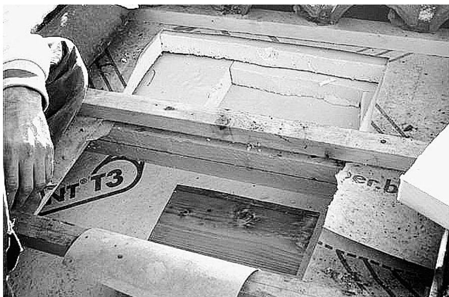
Figura 3.2. L'apertura degli strati di tenuta e dell'isolante ha messo in mostra che il solo strato bagnato è quello del tavolato al di sotto del telo freno vapore
