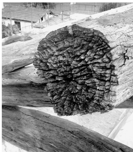
Figura 1.2. La testa delle travi risulta più vulnerabile all'esposizione all'acqua meteorica in quanto le fibre tagliate trasversalmente favoriscono il ristagno d'acqua
