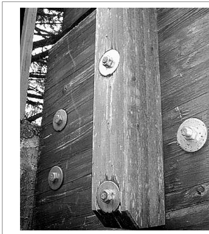
Figura 1.6. Struttura in legno con barre e rondelle ossidate
