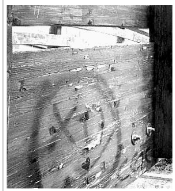
Figura 1.5. Struttura in legno con barre e rondelle ossidate
