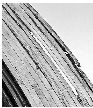
Figura 1.4. Trave in legno lamellare fortemente delaminata e deteriorata
